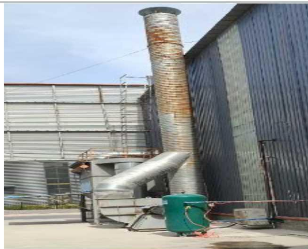
现有工程颗粒物废气治理设施（DA001）
