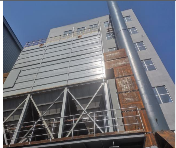
现有焙烧车间填充料加工部除尘器
