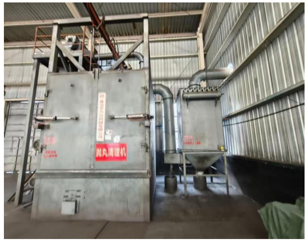
浸渍车间抛丸废气除尘器
