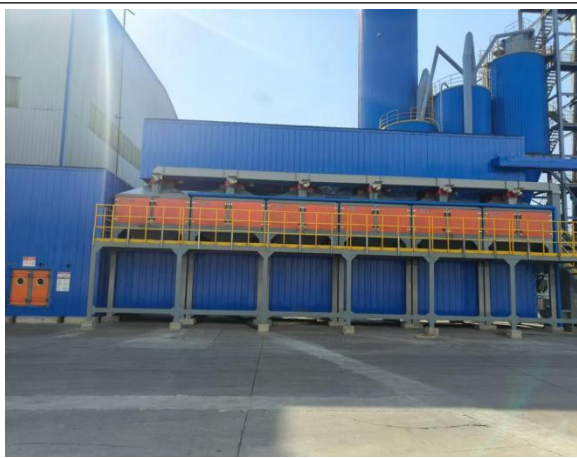
焙烧、浸渍生产线 RCO 催化燃烧装置
