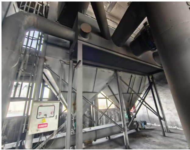
焙烧炉填充料加工 1 线废气除尘器
