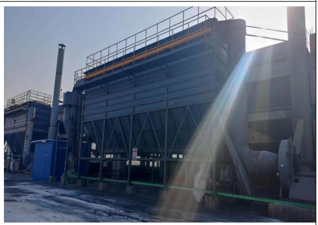
石墨电极生产线旋风+除尘器
