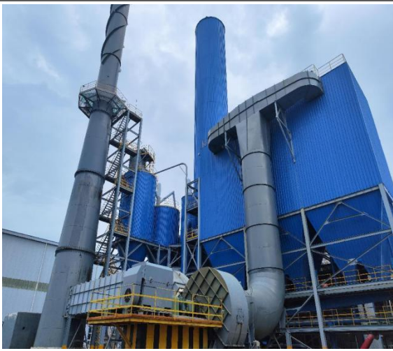
现有焙烧废气干法脱硫+布袋除尘装置
