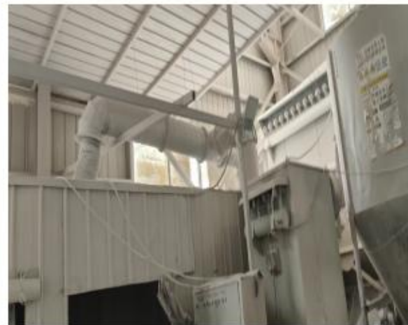
破碎、粉碎工序集气罩+脉冲袋式除尘器
