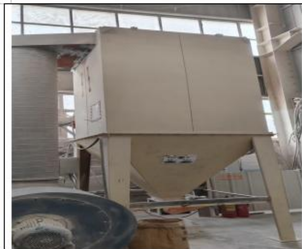
配料、送料、混合搅拌工序脉冲袋式除尘器
