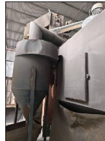
现有抛丸机除尘器
