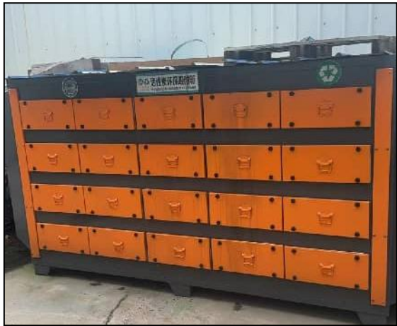
现有工程整改后活性炭吸附装置
