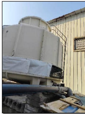
现有工程冷却塔
