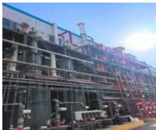
现有1万吨六氟磷酸锂合成尾气处理设施
