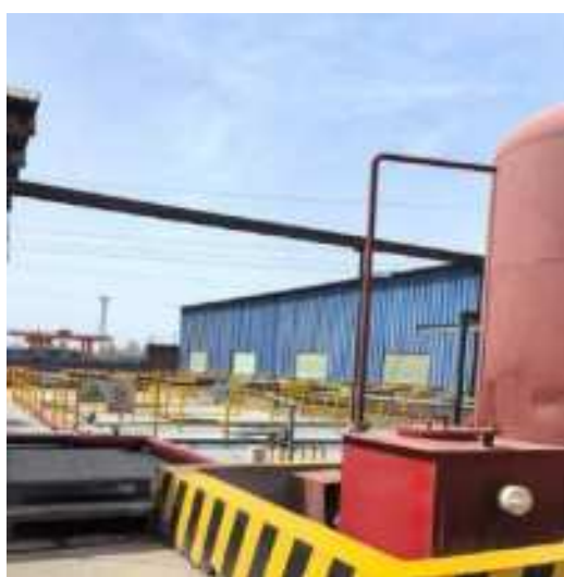
现有含氟污水处理站
