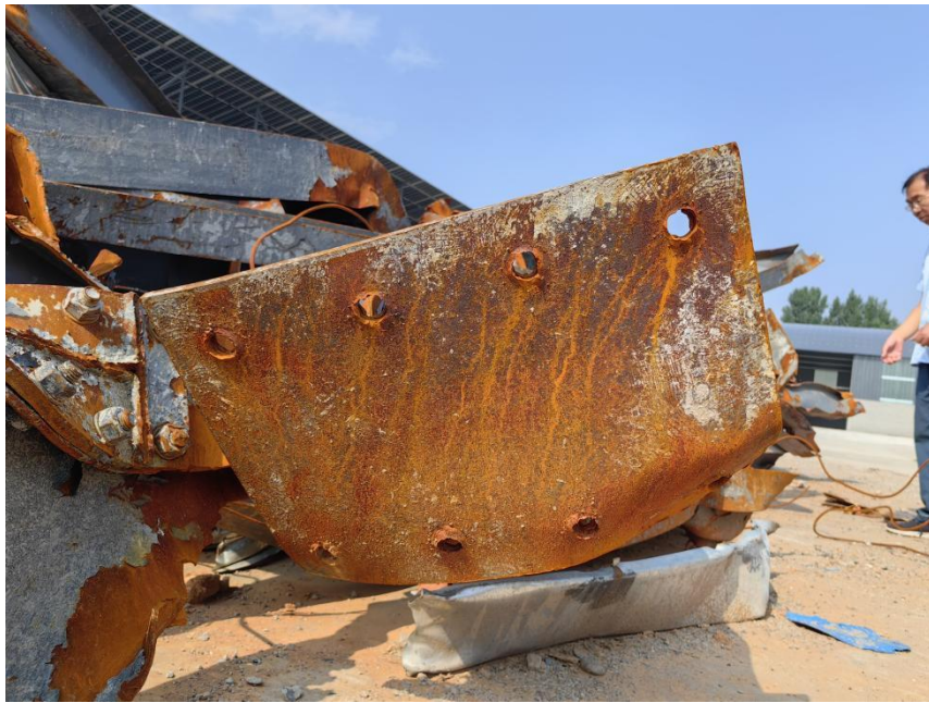
钢结构预埋锚板未设置抗剪键
