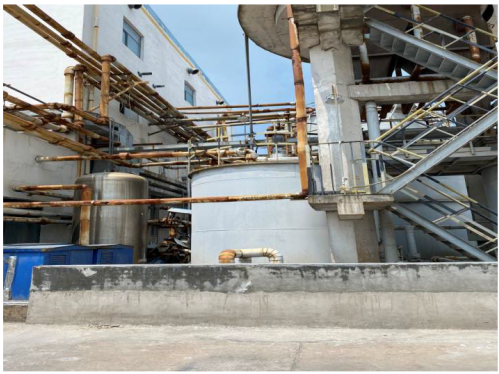
石灰石浆液罐
