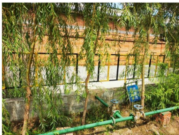
初期雨水收集池
