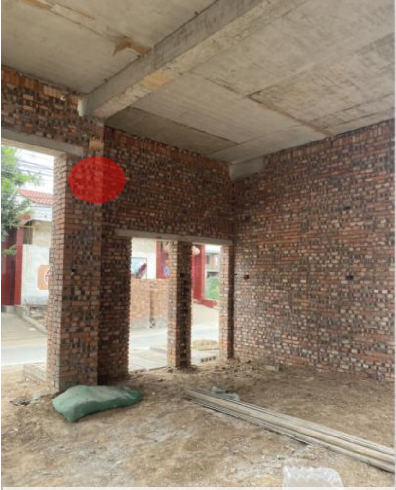
建筑结构缺少构造柱等抗震措施
