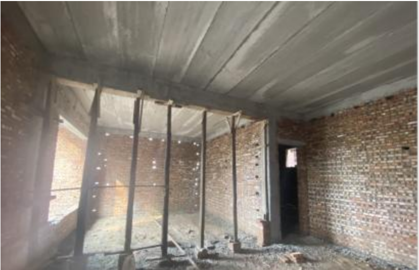
该村部分新建农房中抗震措施缺失 詹店镇——王庄村
